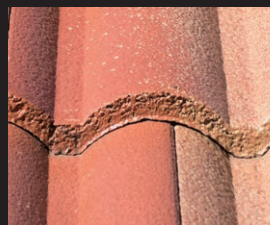
【乾式洋瓦】 瓦の小口が凸凹している
